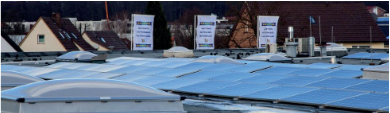
PV-Anlage am Standort Werther: Effiziente Stromerzeugung seit 2016 und aktiver Beitrag zum Klimaschutz
