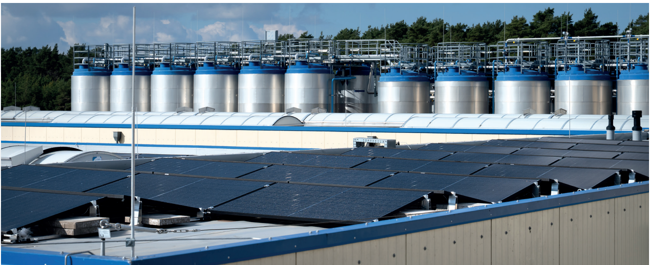
Neue Photovoltaikanlage am Standort Lubmin – ein wichtiger Beitrag zu nachhaltiger Energieversorgung und CO 2 -Reduktion
